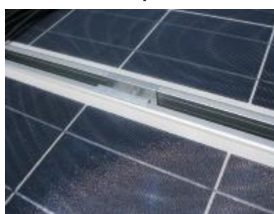
Milieu du champ PV entre modules
